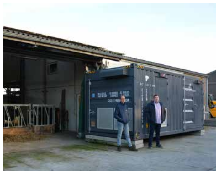
Bert Gielen (links) en Frank Vandijck (Posetron) bij de container met batterijopslag. Bert: “Via deze investering brengen wij onze energieprijzen onder de 1 cent per liter melk per jaar en dat voor 20 jaar.”
